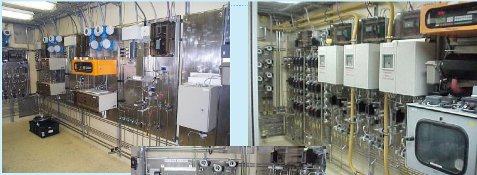
Blick in einen Analysengeräteraum
