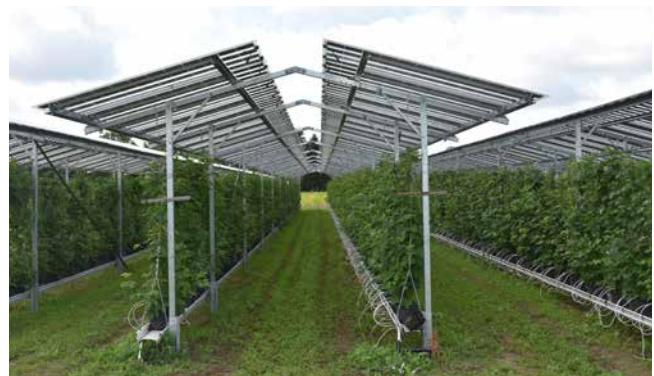
Bild 33: PV-Module mit erweiterten Zellzwischenräumen und Schutzfunktion in den Niederlanden. © BayWa r.e.
