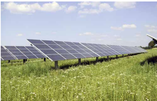
Bild 7: Freiflächen-PV-Anlage. © Fraunhofer ISE
