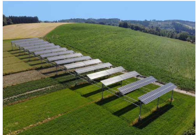
Bild 46: Agri-PV-Anlage in Heggelbach mit einer Leistung von 194 kW p . © BayWa r.e.
