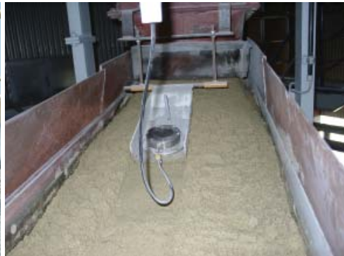
Sensor Litronic-FMS II im Gleitschuhschlitten eingebaut zur Messung von Quarzsand.
